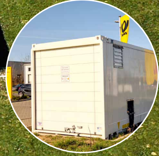
Batteriespeicher zur Speicherung von Solarstrom
