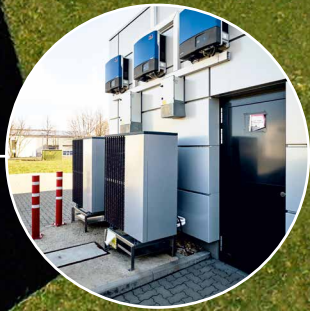
Wärmepumpe in Verbindung mit Fußbodenheizung für die Beheizung des Gebäudes ohne fossile Brennstoffe
